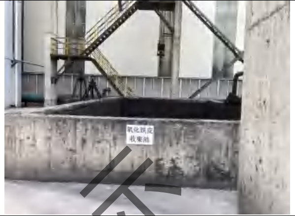
铁皮池沉淀污泥 收集池
