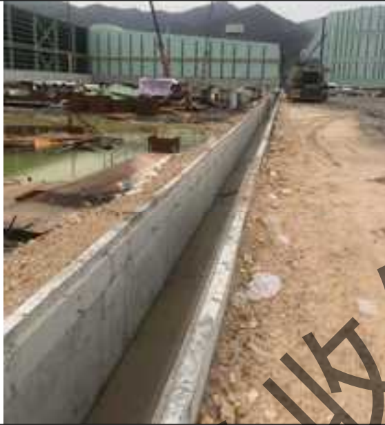
通往初期雨水池的管沟
